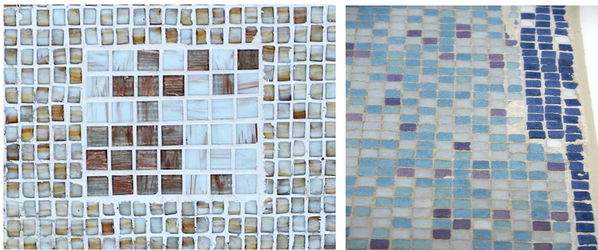
Obr. 6. Oprava obkladu A) jiným typem skleněné mozaiky, B) mozaikou odlišné barevnosti. Foto I. Kučerová
