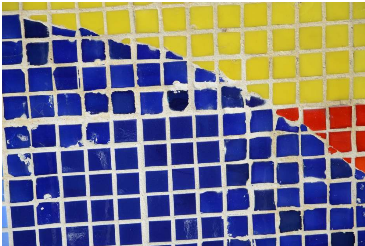
Obr. 25 Stav po restaurování – detail doplnění mozaiky replikami kostek modré barvy. Foto I. Kučerová
